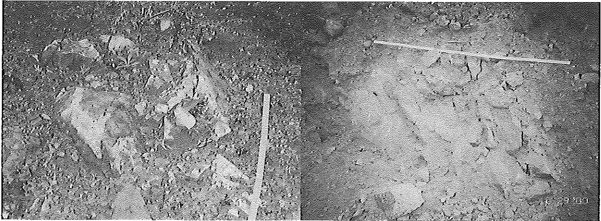
写真4.2.2-12 基盤岩のジグソークラック（地点F） 大きく三つに分解している。基盤岩全体の長径は約80cm。
